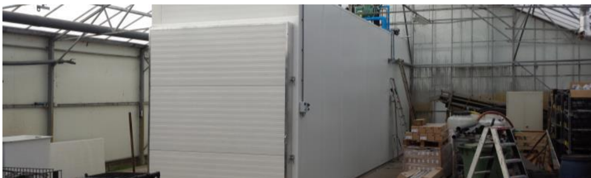
Foto: Heetstookcel bij Spoelbedrijf Warmerdam in Noordwijkerhout
